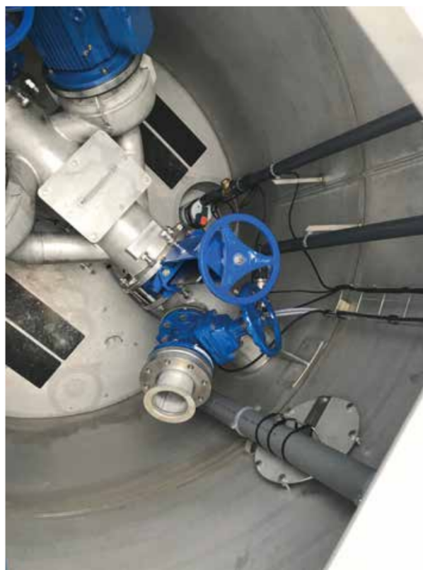
| Système de pompage DIP Booster installé sur site.
